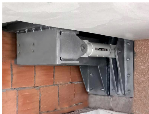
ISOSISM® STU installato su un edificio esistente
